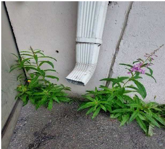
Sadevedet johdetaan rännisyöksyä pitkin sokkelin viereen.
