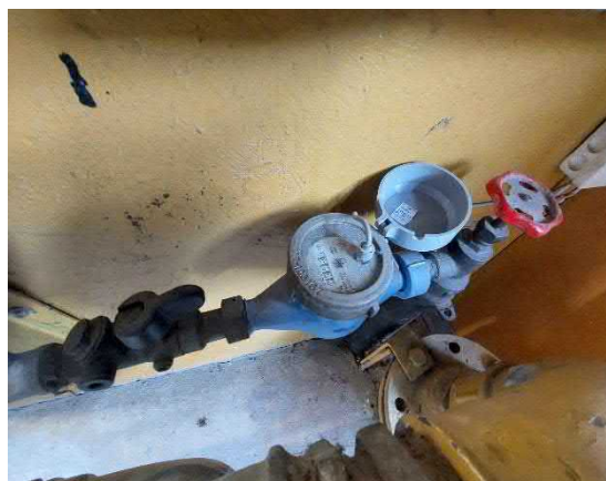
Kiinteistön päävesimittari ja alkuperäiset sulkuventtiilit.
