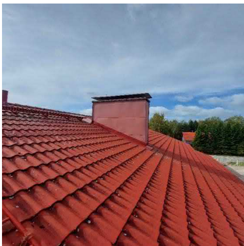
Painovoimainen rakenneaine hormi vesikatolla.
