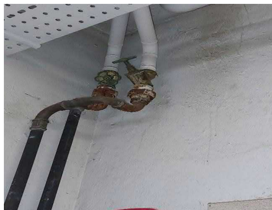
Lämpölinjat ja alkuperäiset sulkuventtiilit autohallissa.
