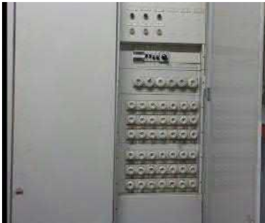
Pääkeskusta teknisessä tilassa
