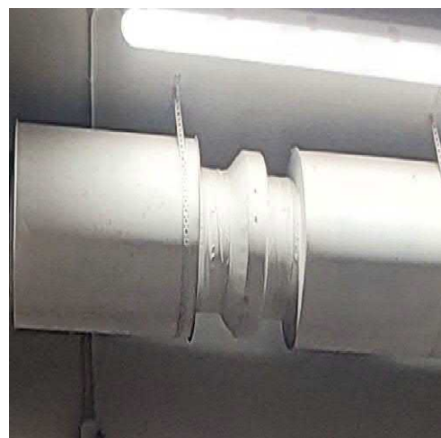
Kiinteistön laajennusosan koneellinen poistoilmanvaihto toteutettu kanavapuhaltimella.
