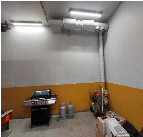
Kiinteistön laajennusosan poistoilmakanavistoa.
