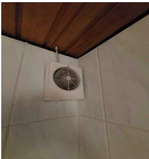
Kylpyhuoneen ilmanvaihtoa tehostettu PAX-puhaltimella.
