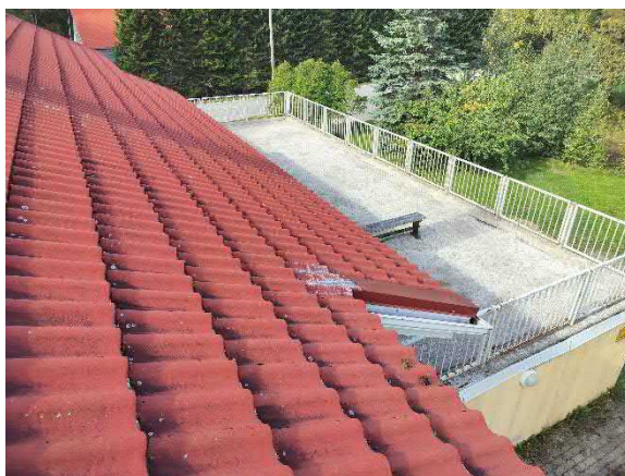
Taaempänä näkyvän reunapellin tiivistys on puutteellinen
