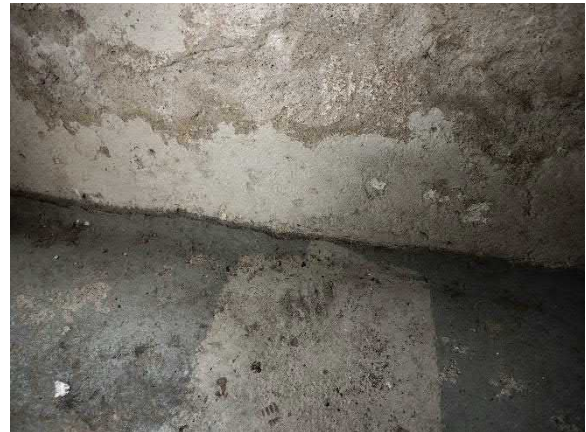
Alakerran lattian rajassa paikoittaisia vaurioita
