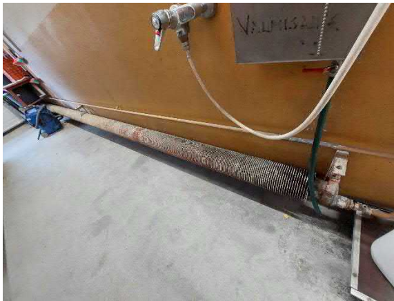
Autohallin heikkokuntoinen lämmityspatteri.
