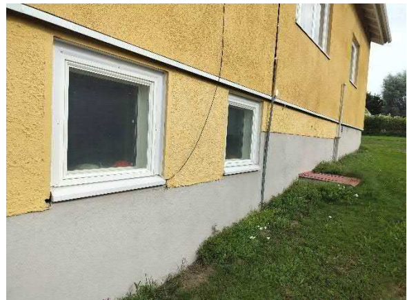
Perusmuurien ulkopuolisesta vedeneristystä ei havaittu
