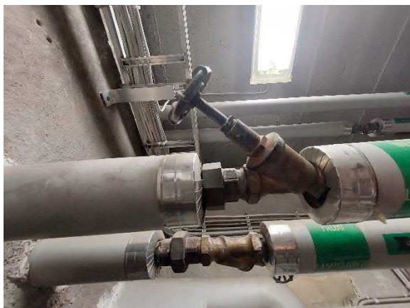
Lämmönjakohuoneessa sijaitsevat alkuperäiset sulku- ja linjasäätöventtiilit.
